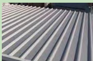
金属板折板葺 【仕様が好ましくない】
