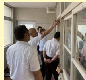
老朽化のため、補強されているドア枠
