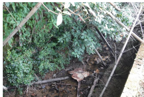
写真5：すうだ池下流で、流水が葺司西側の水際を削る未整備の水路
