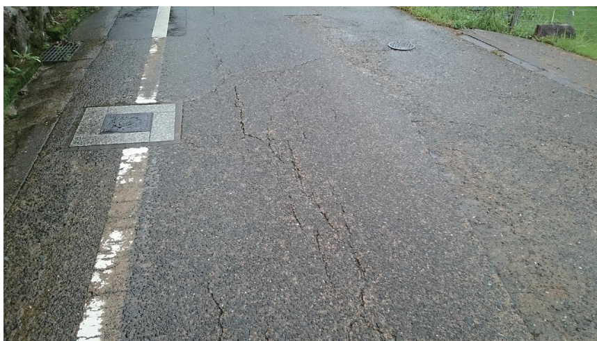
写真 7：舗装の劣化が目立つ歴史の散歩道（市道213／月山・大裏線）
