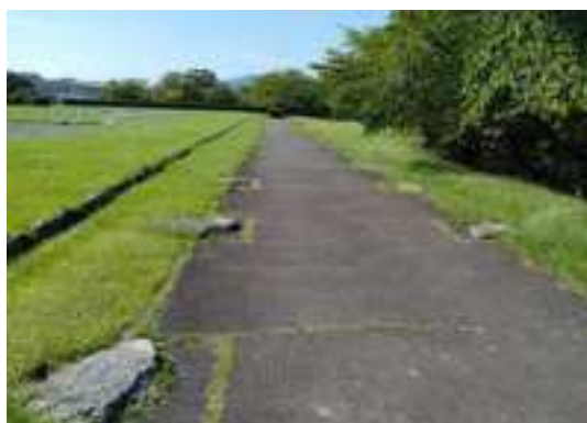
写4-11：劣化が目立つ平面復元箇所（回廊）
