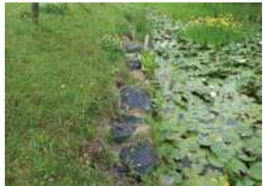
写4-8：護岸が崩落した濠
