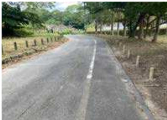
写4-13：劣化が目立つ道路（歴史の散歩道）
