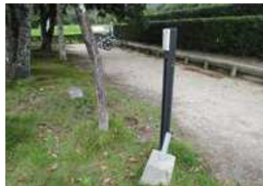
写4-20：破損した案内板の支柱
