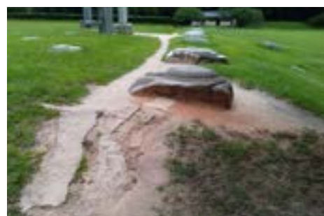
写4-1：毀損が目立つ正殿跡
