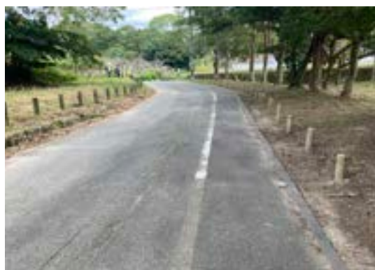
写4-13：劣化が目立つ道路（歴史の散歩道）
