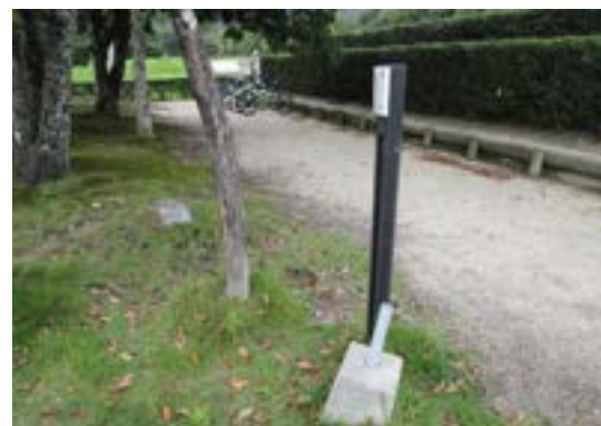
写4-20：破損した案内板の支柱
