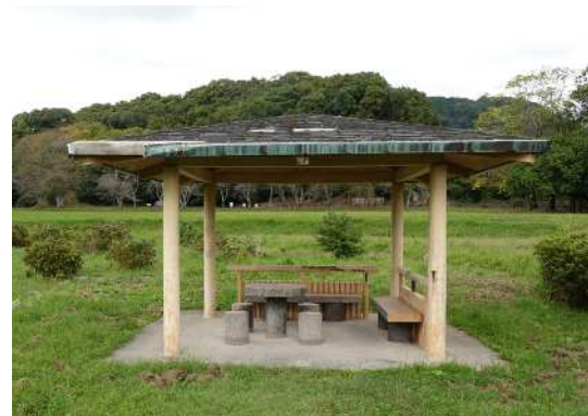
写4-24：支柱のコンクリートが爆裂し鉄筋がむき出しとなった四阿
