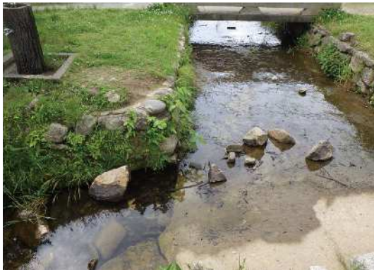
写4-7：河床のひび割れ・護岸の落石が目立つ水路
