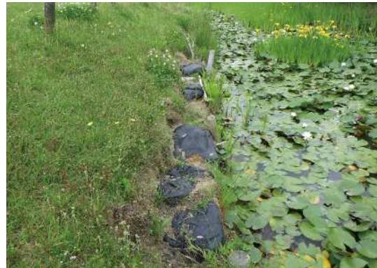
写4-8：護岸が崩落した濠
