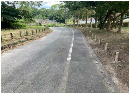
写4-13：劣化が目立つ道路（歴史の散歩道）
