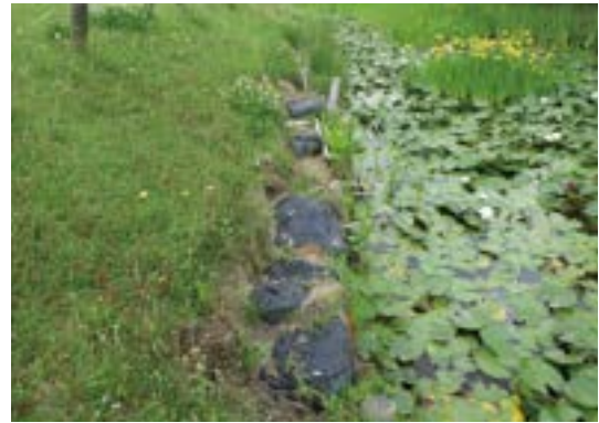
写4-8：護岸が崩落した濠
