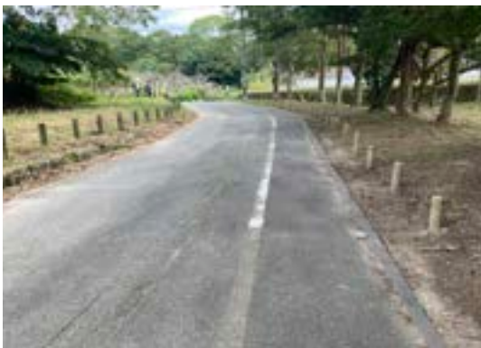
写4-13：劣化が目立つ道路（歴史の散歩道）
