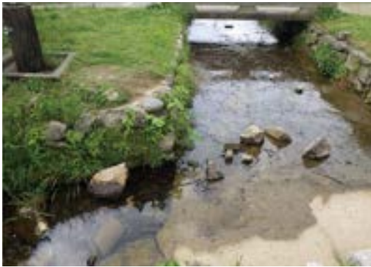
写4-7：河床のひび割れ・護岸の落石が目立つ水路
