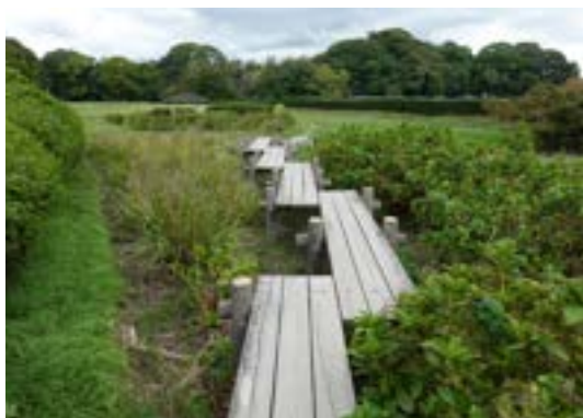
写4-15：バリアフリー環境が整っていない通路
