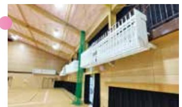
学校体育館の空調
