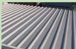
金属板折板葺 【仕様が好ましくない】
