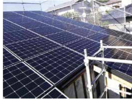
太陽光発電システム
