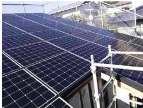
太陽光発電システム
