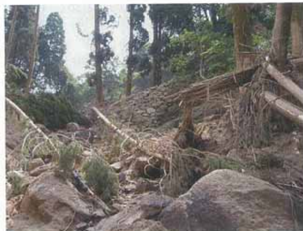
▲大石垣 (平成15年7月19日の災害後の状況)
