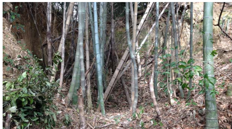
図 8-1: 東門跡周辺の土塁き損部
