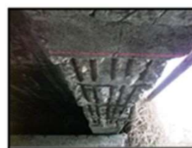
緊急措置が必要な状態
