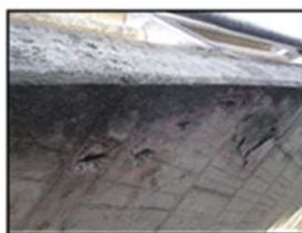
措置が必要な状態
