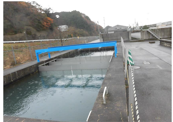
薬品沈殿池傾斜板
