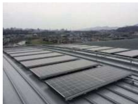
太宰府市総合体育館太陽光発電施設
