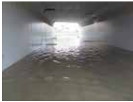
工事前の冠水状況
