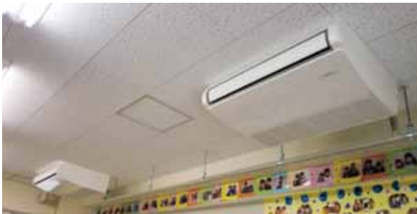
普通教室に設置しているエアコン
